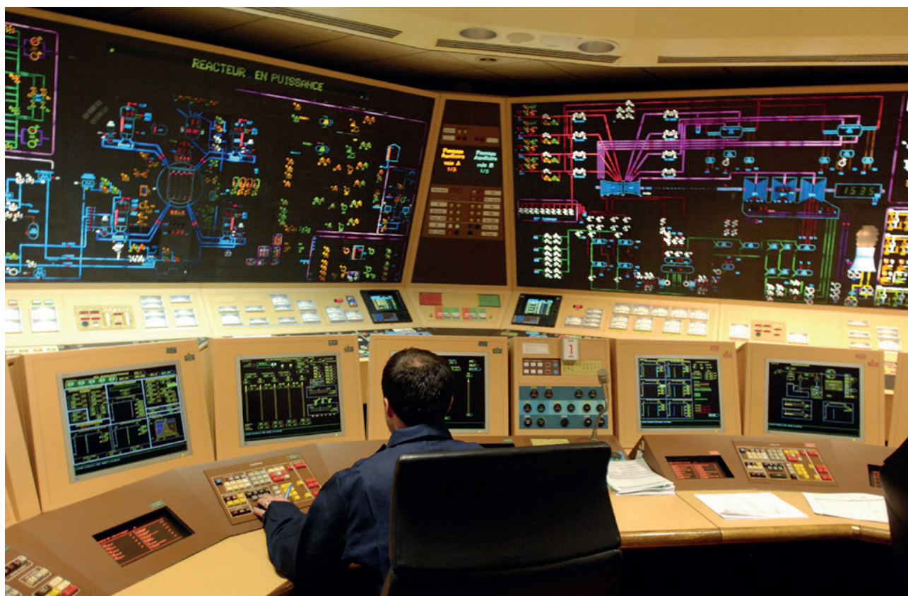
La salle de commande de la centrale de Chooz (Ardennes).
