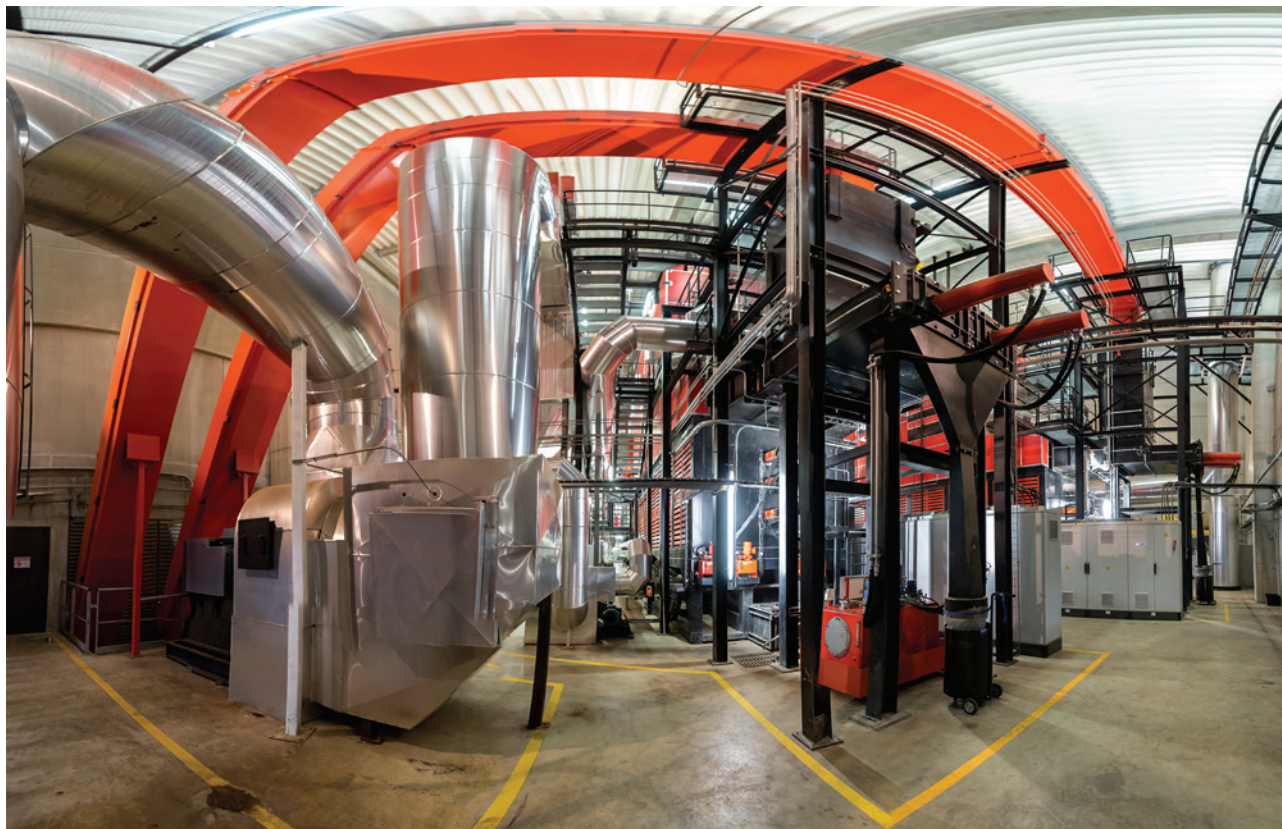
Réseau de chauffage urbain de la ville de Châlon-sur-Saône : chaufferie communale au bois de 130 mégawatts.
