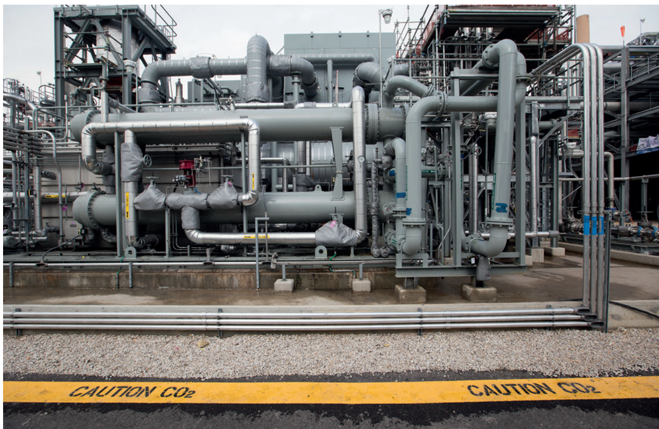
Installations de capture du carbone d'une centrale électrique au sud-ouest de Houston (Texas).
