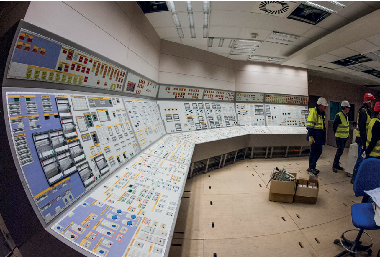
La salle de contrôle de la centrale nucléaire EPR de Flamanville (dans la Manche).
