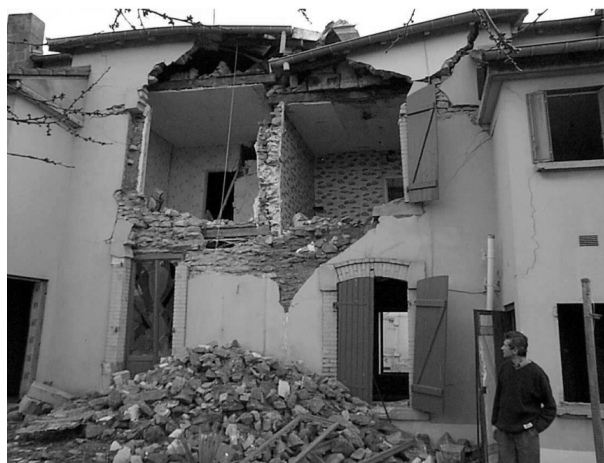
Figure 2 – Dommages causés au bâti par les désordres d'Auboué, en 1996.
