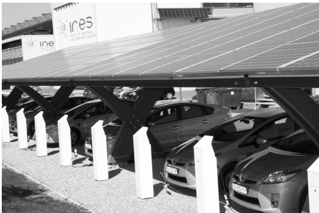
Photo 1 : Illustration de la convergence entre habitat et transport : expérimentation à l'INES de la recharge de véhicules hybrides par des toits solaires photovoltaïques.
