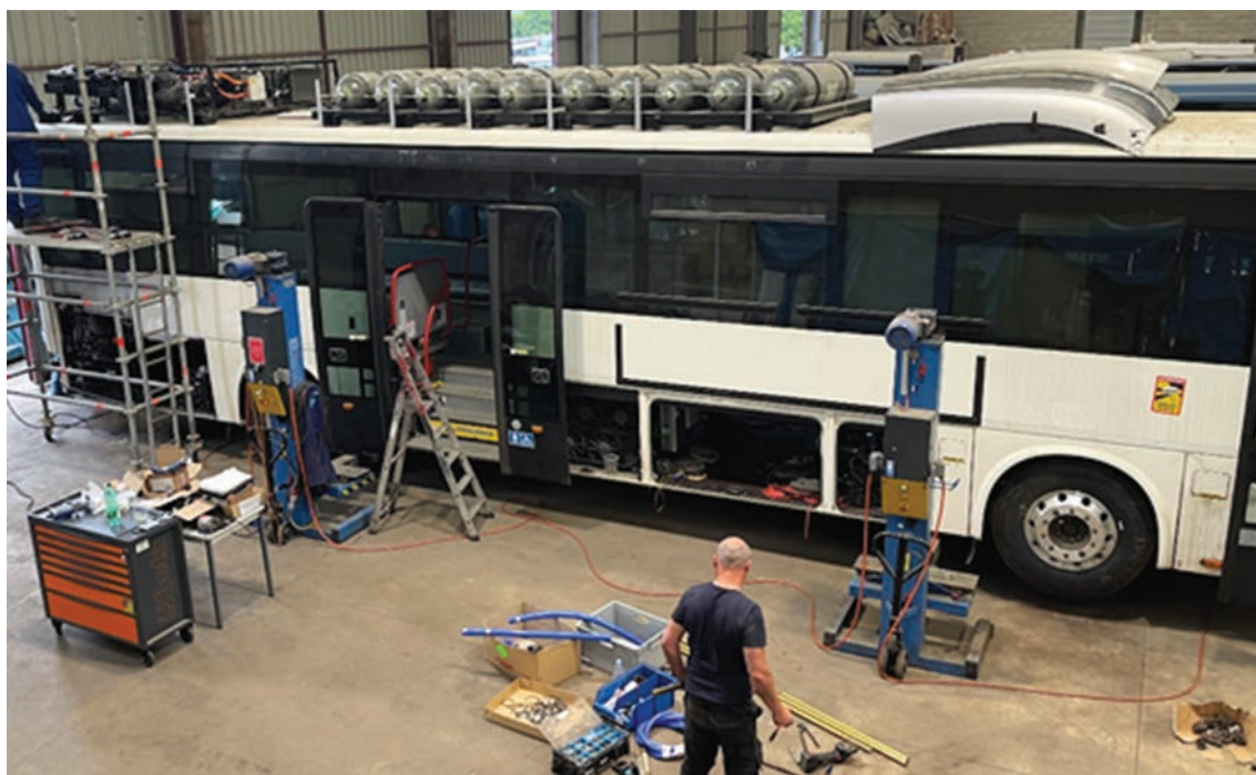
Figure 6 : Installation en toiture des bonbonnes d'hydrogène et de la pile à combustible (photo©Transdev Normandie).
