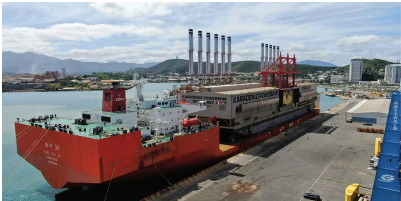
Figure 10 : Centrale accostée temporaire (CAT) au fioul de la SLN pour l'alimentation électrique de Doniambo (Crédit photo : Outremers 360°, nov. 2022).
